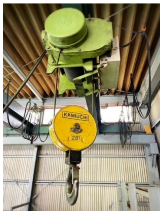
2.8トン天井クレーン
